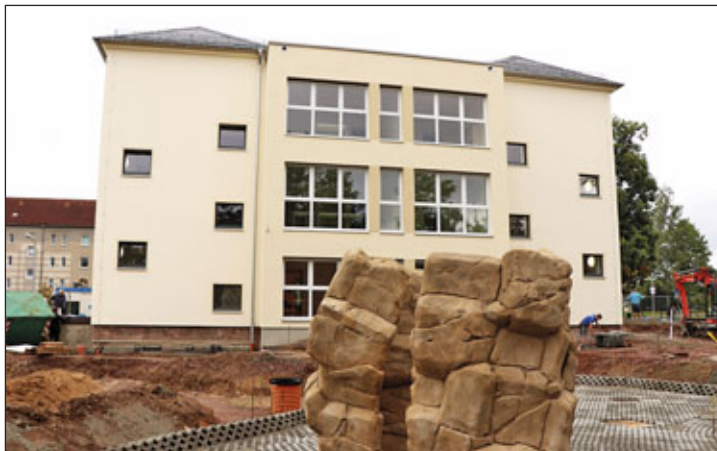
Saniertes Kita-Gebäude an der Poststraße – ab September übernimmt der Nikolausverein in Trägerschaft des Diakonischen Werkes Rochlitz den dortigen Hortbetrieb.
