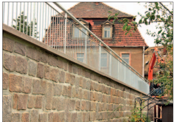
Die Sanierung mit Ersatzneubau Stützmauer im Eckbereich Hohe Gasse/ Mühlgraben wird fortgeführt.
