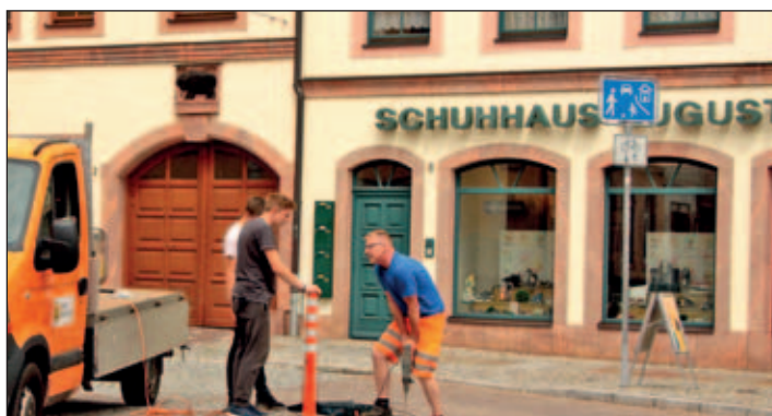
Seit 1. Juli ist das Linksabbiegen in die Burgstraße ausdrücklich erlaubt. Im Foto: Mitarbeiter des städtischen Bauhofs nehmen die Neubeschilderung vor und installieren einen Kunststoffpoller.
