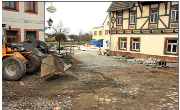
Am Mühlplatz sind die Pflasterarbeiten im unteren Bereich bis Höhe Gerichtsschänke abgeschlossen. Die Fertigstellung der Baumaßnahme ist für das 2. Quartal geplant. Fotos: Jörg Richter
