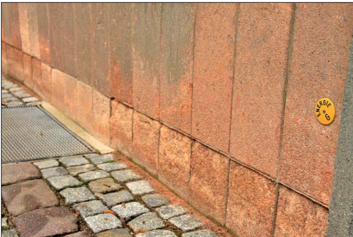
Folgeschäden von Nässe und Streusalz an einer Hausfassade in der Rochlitzer Innenstadt.
